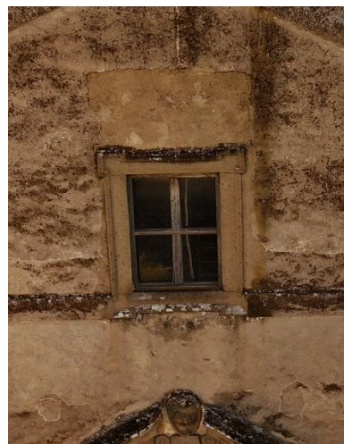
Figura 6 – Il corrispondente rappezzo di intonaco in facciata
