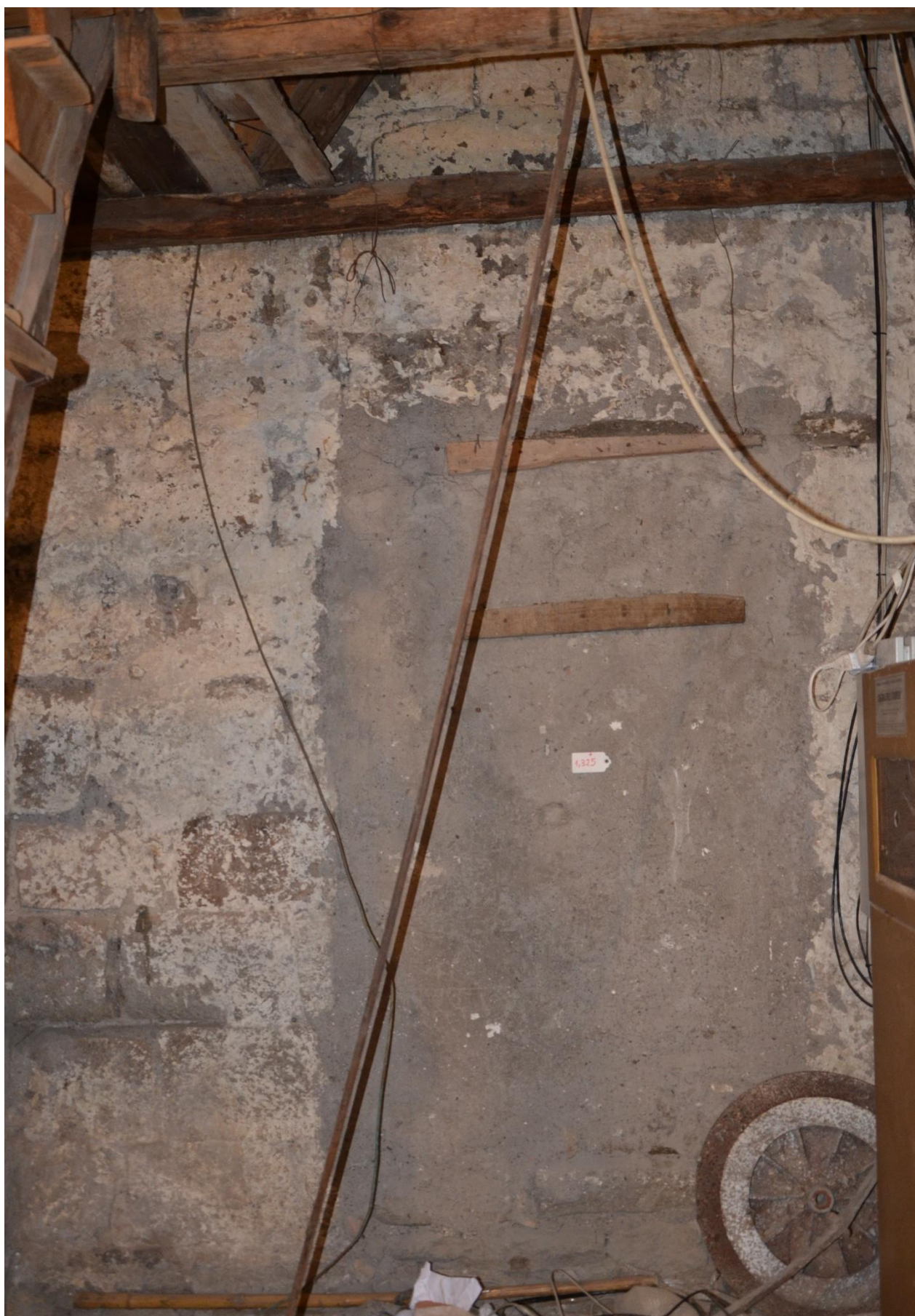
Fig. 13: Porta tamponata nella Zona 1.
