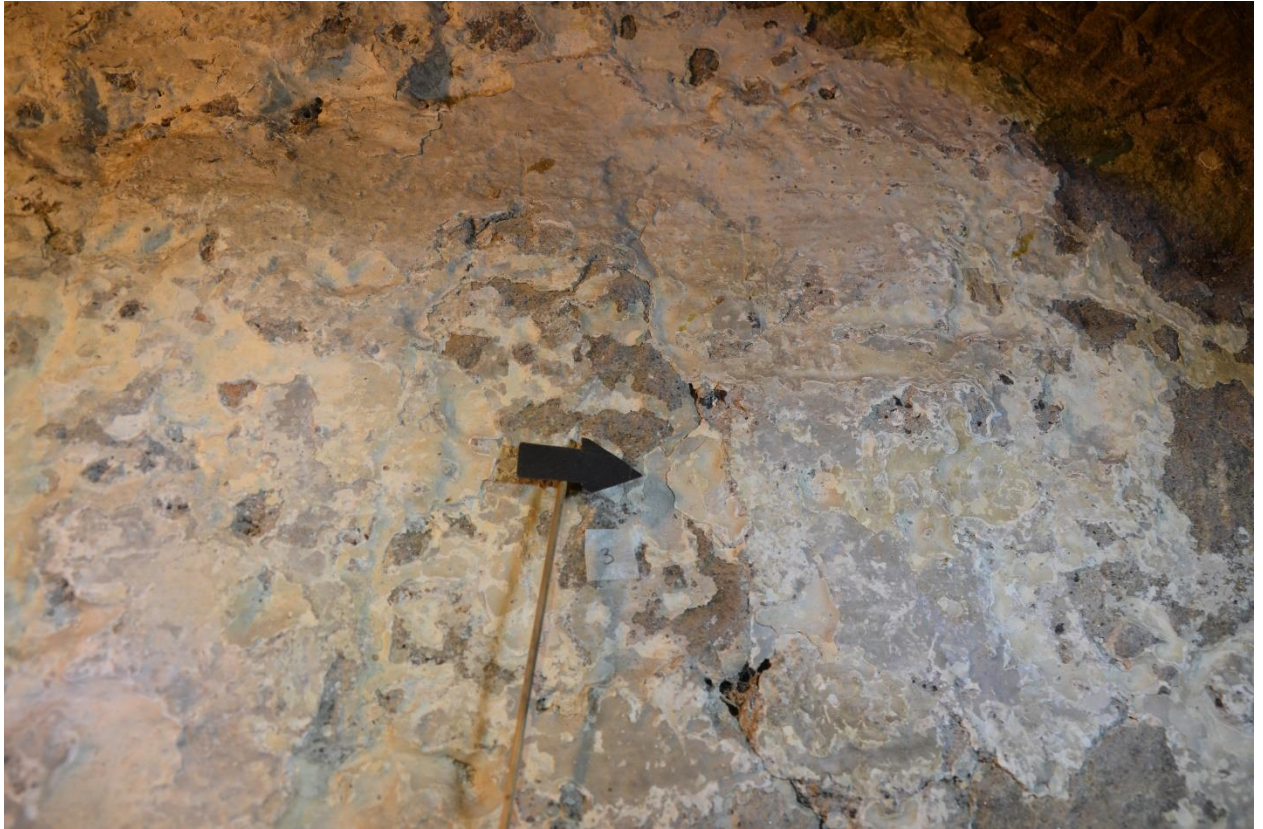
Fig. 12: Strati di scialbo sulla muratura della Zona 1.
