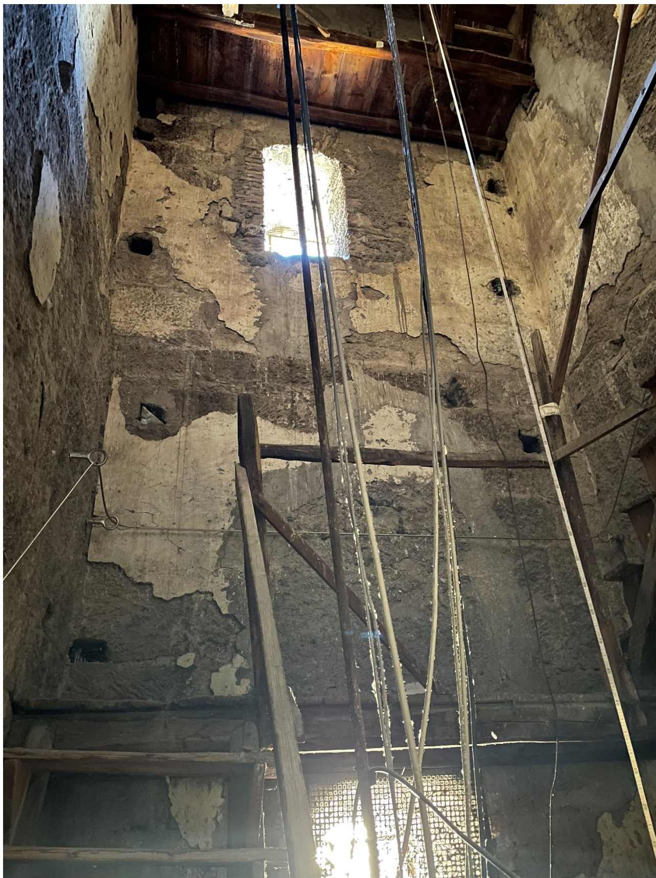
Parete della torre, al primo livello, in corrispondenza della porta di collegamento con gli uffici. Si notano: gli interventi inidonei da rimuovere, come le stuccature in cemento, le porzioni di intonaco da consolidare, le buche pontai e il paramento murario a vista da restaurare
